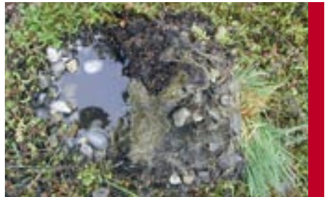
Vernässt bis an die Oberfläche durch zu wenig Gefälle und zu hoch gesetzte Abläufe
