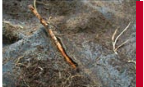
Rhizome, welche die Dachhaut zerstört haben
