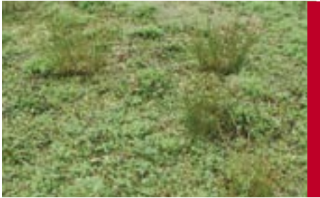
Binsen und Seggen sind oft wurzelaggressiv und können die Dachhaut zerstören
